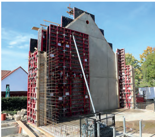
Štítová železobetonová stěna bedněna dvěma nastavenými panely výšky 300 cm, které ušetřily spínáním z jedné strany další bezpečnostní zařízení.
