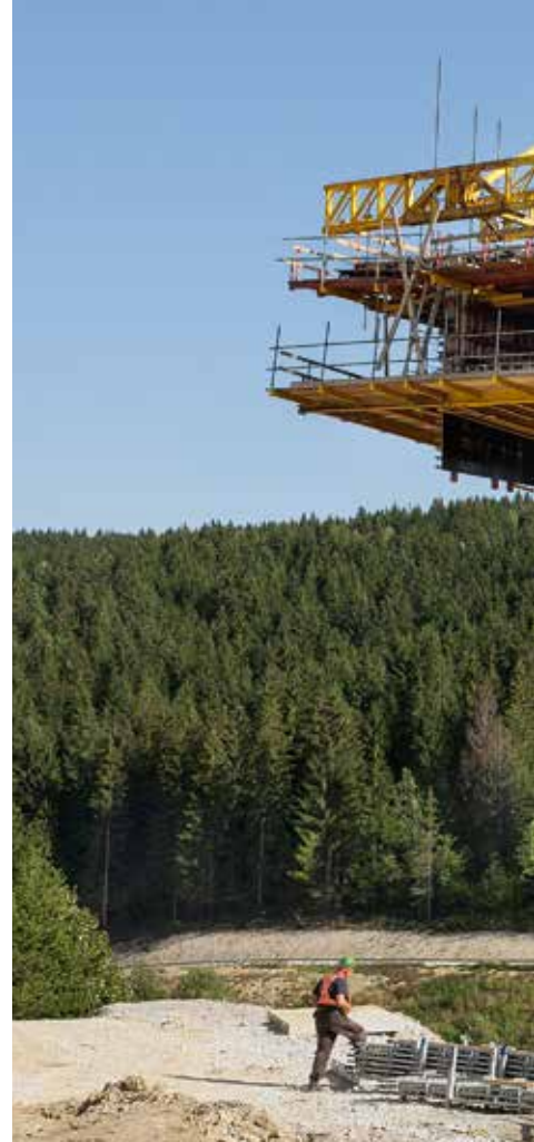
Stavbu provedl STRABAG s.r.o., Bratislava Návrh bednění a lešení PERI Jesenice a Zlín
