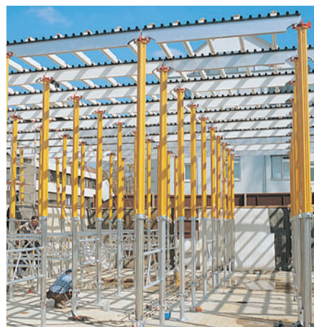
U vysokých konstrukcí se pro zvýšení stability stojek MULTIPROP nasazují rámy MRK.
