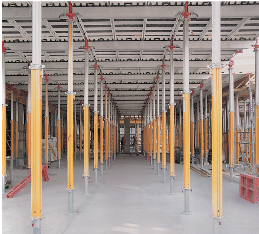
MULTIPROP 350 s patkami MP 50 společně s bedněním SKYDECK, coby bednění stropu se světlou výškou 4,10 m.
