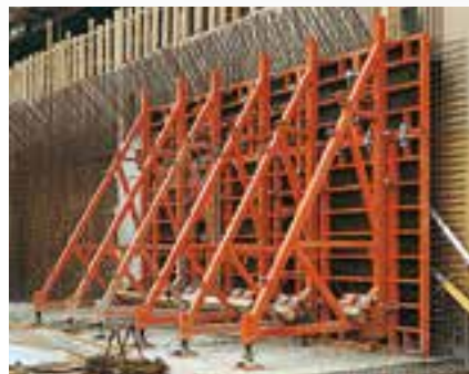
Opěrné rámy SB-B a SB-C s rámovým bedněním PERI TRIO, výška betonáže 3,50 m.
