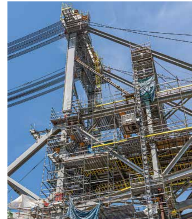
10 Podpěrné konstrukce i přístupy ze systému PERI UP Flex Montáž rypadla pro důl Bílina
