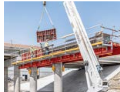
VSS umožňuje nezávislé použití bočního stěnového bednění, odbednění následující den a komfortní armovací práce.
