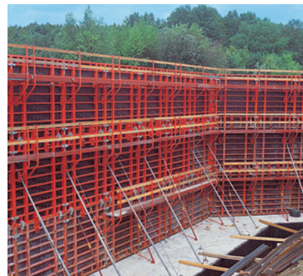
TRIO u průmyslového objektu.
