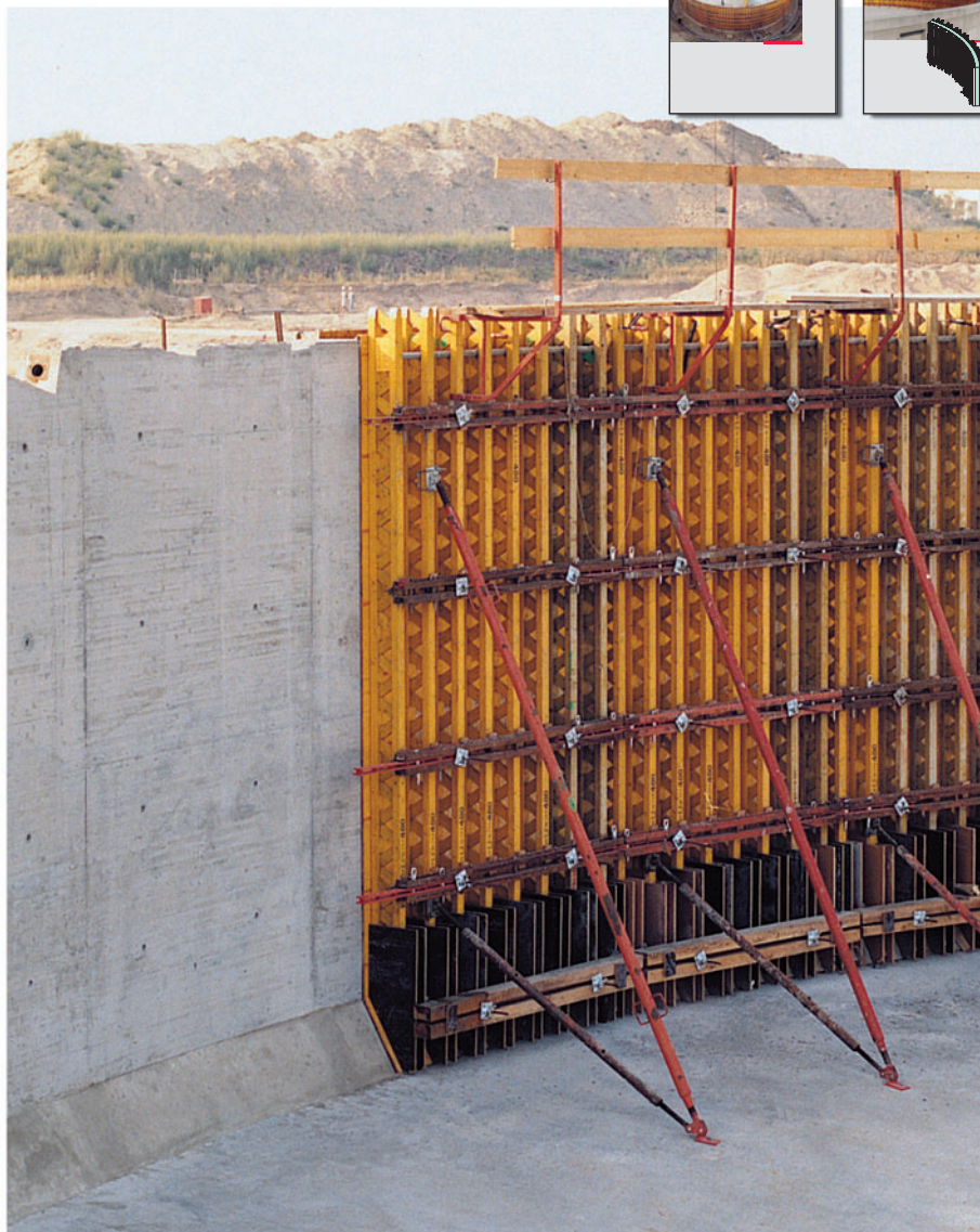
Náběh u přechodu dna a stěny byl předem namontován na stěnové bednění VARIO a společně s panelem tvořil přepravovanou sestavu.
