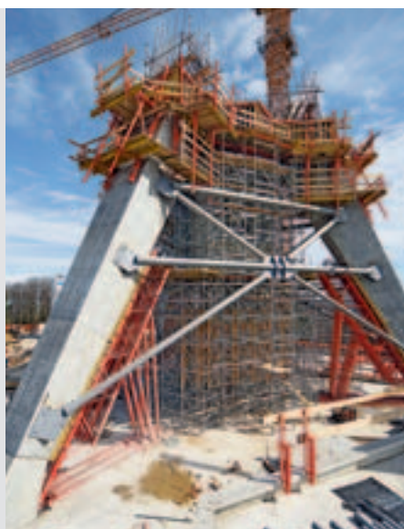
Stejné systémové díly pro dočasné podepření konstrukce jako při použití šplhavé konstrukce.
