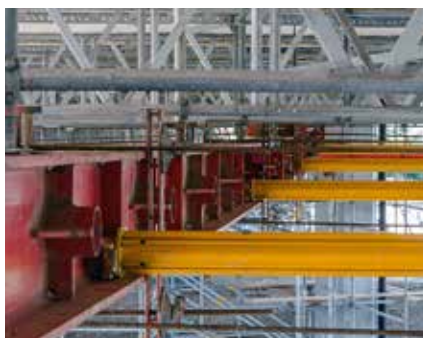
Uložení lešení PERI UP na ocelových profilech HEB s výztuhami ze stojek MULTIPROP.
